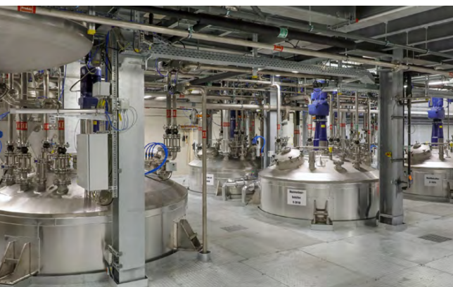
Behälterbereich einer Flüssigherstellanlage für Emulgierbare Konzentrate (EC) und Suspensionskonzentrate (SC)
